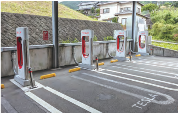
EV用急速充電器のほか、テスラ専用スーパーチャージャーも設置。
